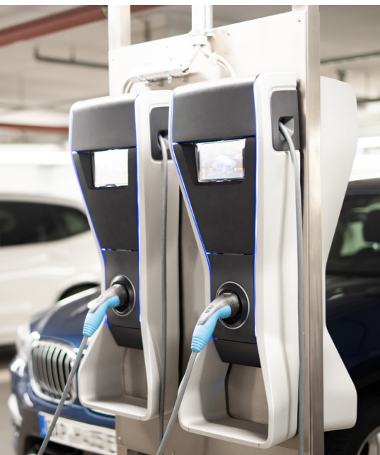
In einigen Tiefgaragen haben die SWE bereits Ladeinfrastruktur aufgebaut.
