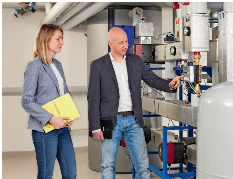
Die Salucci-Höfe in Esslingen-Weil werden mit Fernwärme von den SWE versorgt.
